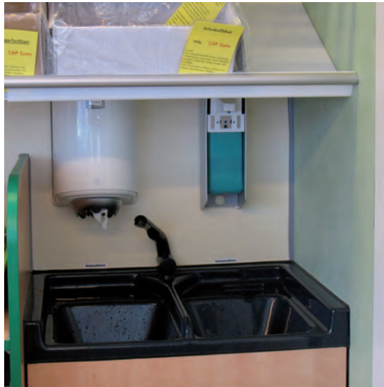
Abbildung 6: Doppelbecken zur Trennung von Spül- und Handwaschbereich in einer kleinen Betriebsstätte.
